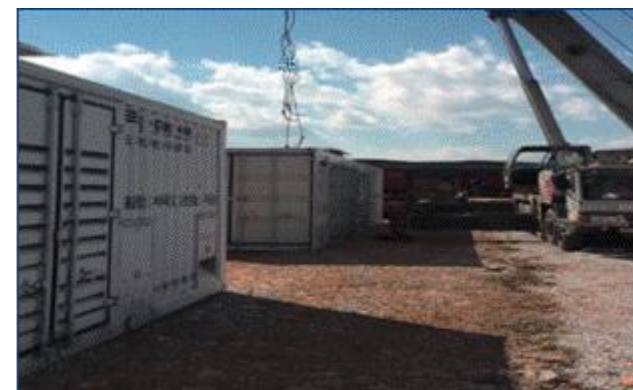
35kV/4MVA新能源测试平台
